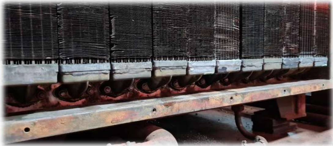
Bild 8: Fertig aufgearbeitete Kühleranlage, Frühjahr 2022. (Foto: Ing. Stefan Rottensteiner)
